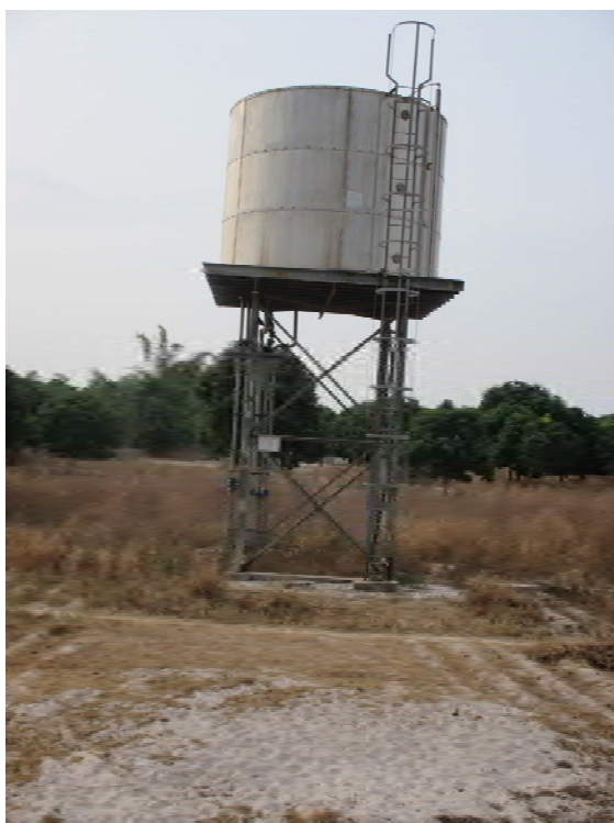
der neue 60.000 ltr. Trinkwassertank
